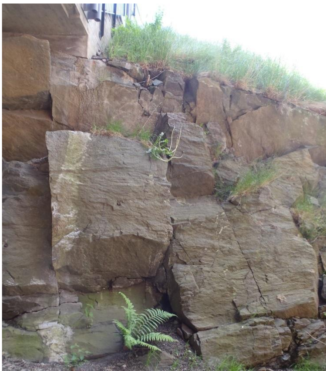
Figur 28: Brantstående spricksystem nära skolbyggnaden.
