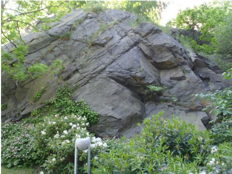
Figur 14: korsande spricksystem i bergslänten vid Kv 29 Lilla Jägaren. Dessa spricksystem återfinns inte i bergslänten vid Friskis & Sveltis-husets södra sida, och bedöms därför utgöra ett yttligt fenomen.
