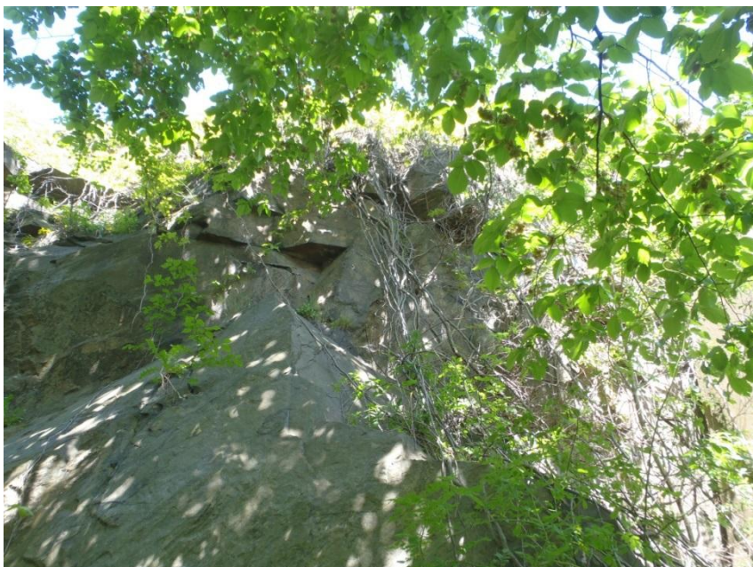
Figur 20: Rik växtlighet hindrar till del inspektion av bergslänten.
