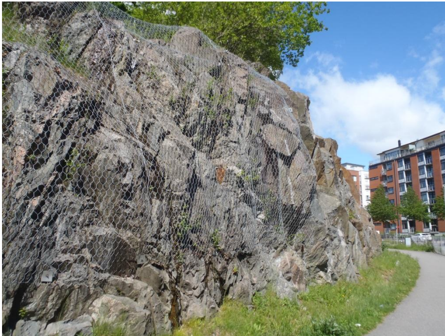
Figur 24: Stora delar av bergslänten ut mot Östra Eriksbergsgatan är bultad och nätad.
